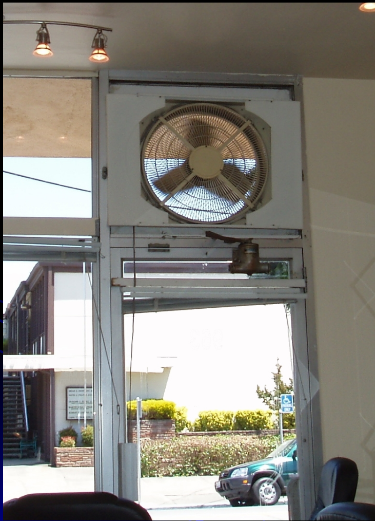
Door mounted exhaust fan
